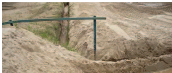
FOT. 12 Nie zabezpieczono i nie oznaczono tablicami ostrzegawczymi otwartego kanałika spływu wody z układu segregacyjnego zakładu przerobczego do zbiornika osadczego
